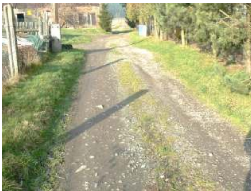
Fot. 2- Dalsza część drogi pomiędzy budynkami nr 28 i 29. Widoczne deformacje i uszkodzenia nawierzchni.
