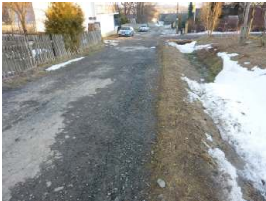
Fotografia 2- Zniszczona nawierzchnia drogi oraz rów w środkowej części drogi.
