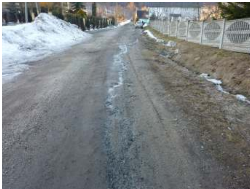
Fotografia 1- Początek remontowanego odcinka drogi. Uszkodzona nawierzchnia drogi. Brak skutecznego odwodnienia.
