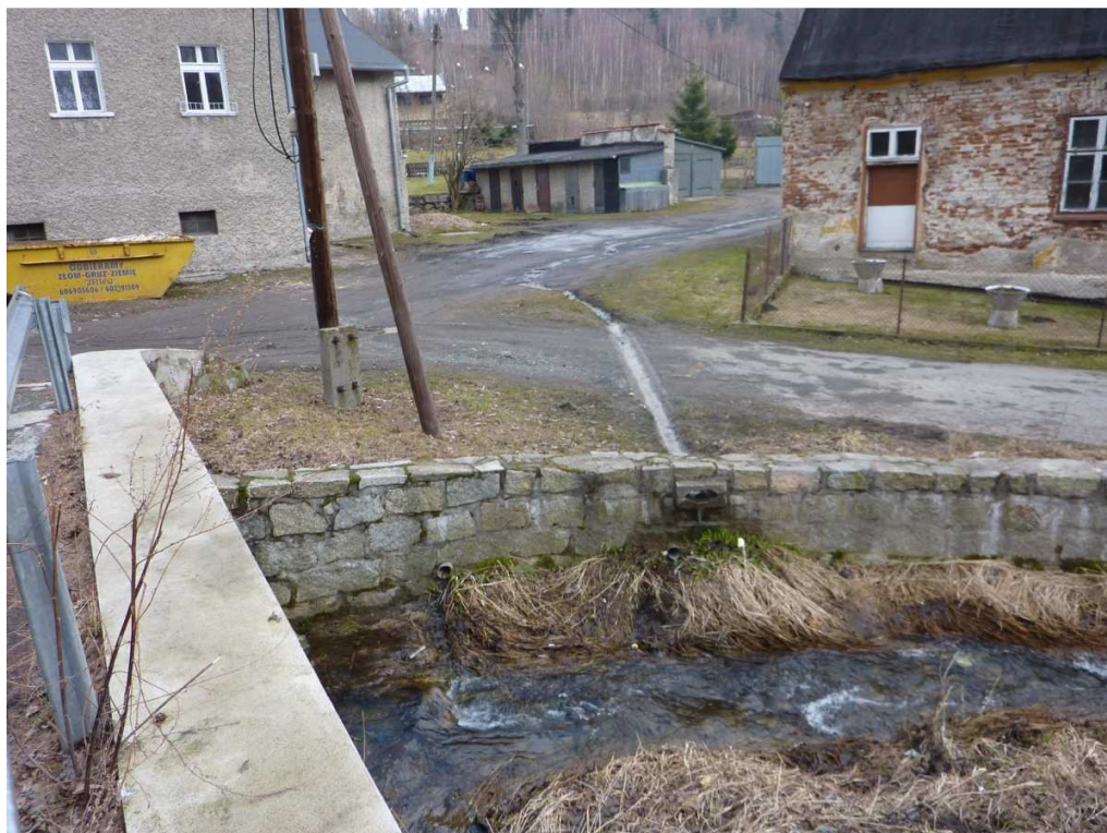
Fot. 2 Widok istniejącego odwodnienia na włączeniu do drogi gminnej z pobliskiej zabudowy i nawierzchni drogi
