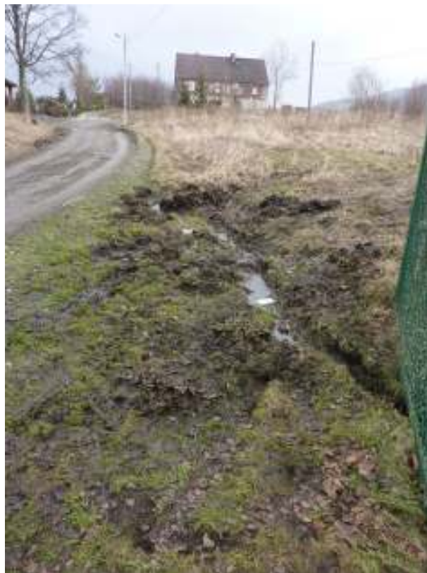
Fotografia 7 - Zniszczony rów przydrożny
