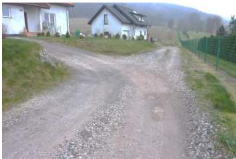
Fotografia 4. Ogólny stan nawierzchni odcinka C-D.
