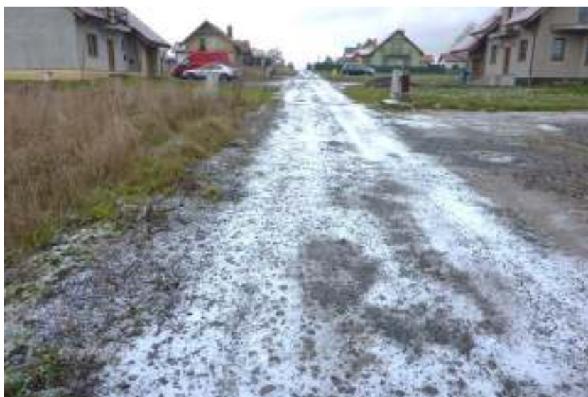
Fotografia 2- Ogólny stan nawierzchni. Zanieczyszczony rów przydrożny
