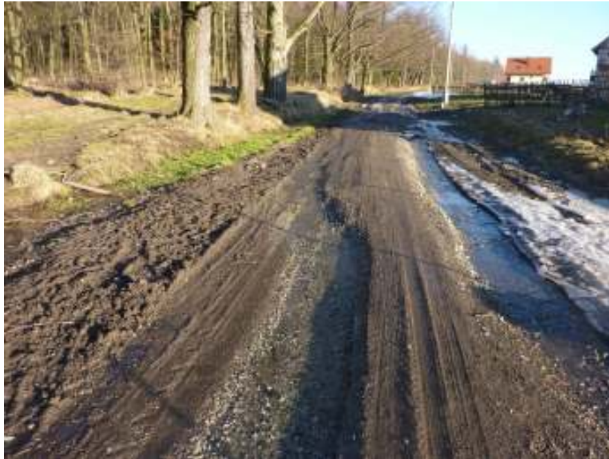
Fotografia 1- Uszkodzona nawierzchnia drogi. Brak skutecznego odwodnienia. Zniszczony rów odwadniający od strony lasu.
