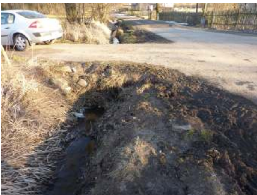
Fotografia 3- Zniszczony przepust na zjeździe na drogę dz.149
