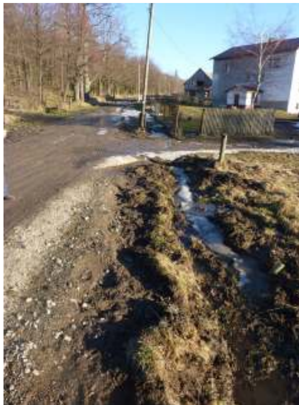
Fotografia 2- Zniszczone pobocze drogi oraz rów prawy w dolnej części drogi. Uszkodzony przepust pod zjazdem na posesję
